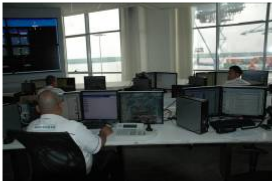
圖35. 巴生港西港資料中心一隅。
