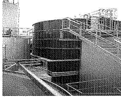
圖 3. Kohler 廠快速沉澱池
