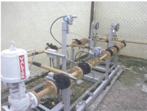
廠區氮氣供應減壓站
