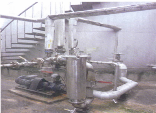
灌裝泵均裝設 25 Micro 微分過濾器
