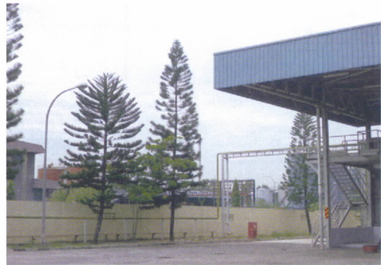
氮氣管線經灌裝場至油槽區
