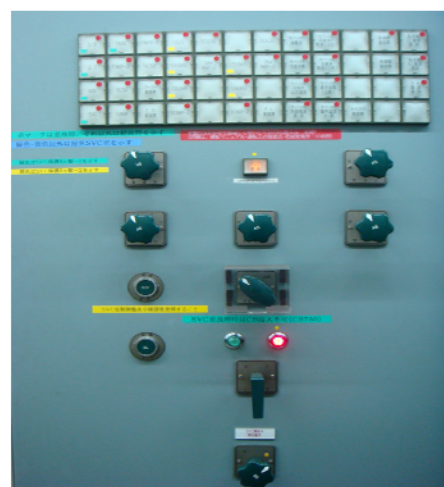
監視盤(警報盤)
