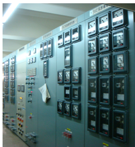
控制室SVC各盤面(電驛盤、輔助電驛盤、監視警報盤)
