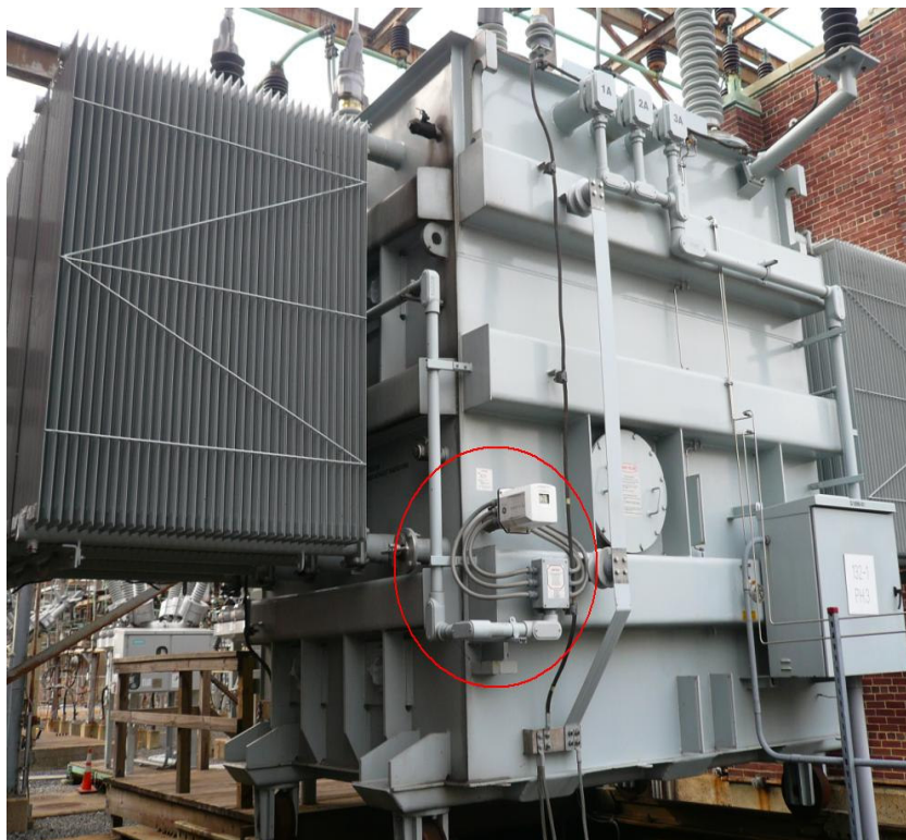
圖 4 裝於電力變壓器上之 Hydran M2
