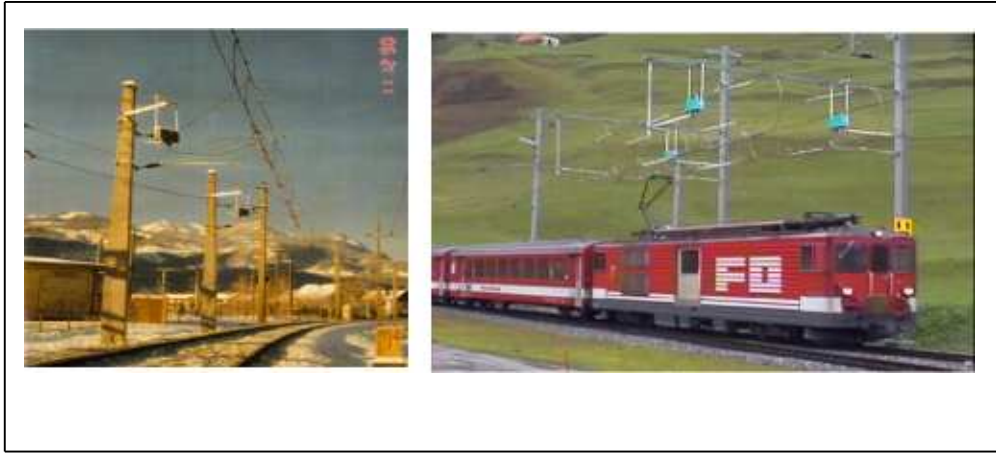
圖 8-6 中性區間現場裝置。
