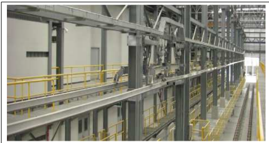
圖 8-10 移動式導電軌無運轉縮回(接地)位置
