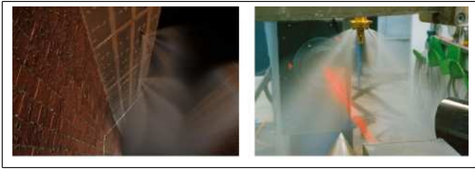
圖 7-8 隧道滅火系統
