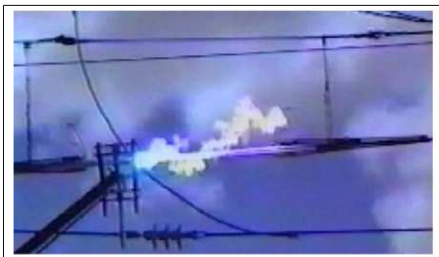
圖 8-2 電力列車負載未切通過中性區間之電弧
