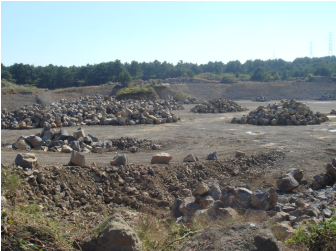
照片 3.3-2 Ongpo 農業用水發展計畫(Ongpo agricultural water development project) 現場水庫施工情形
