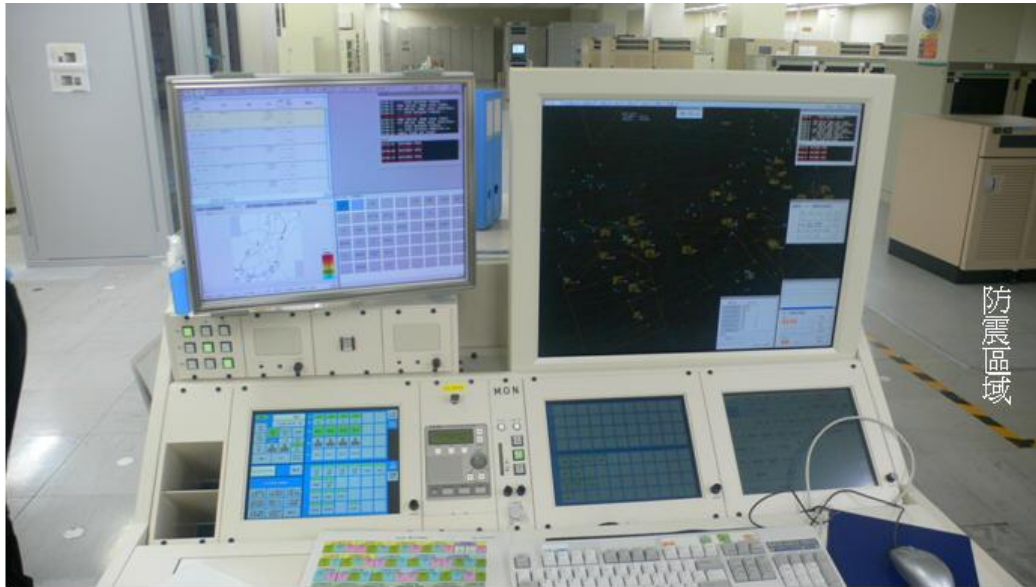
圖 8 RDP 機房終端維護設備
