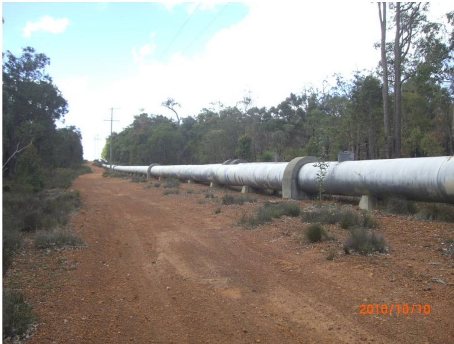
附圖 5 說明：圖片中送水幹管負責將 Mundaring Weir 所攔蓄之水源，以加壓方式送水至 560km 外之「arid goldfields」高地使用，此加壓供水系係於 1890 年開發使用迄今。其加壓送水管輸水長度及開發年代，對國內而言亦屬特殊案例，極具參考價值。
