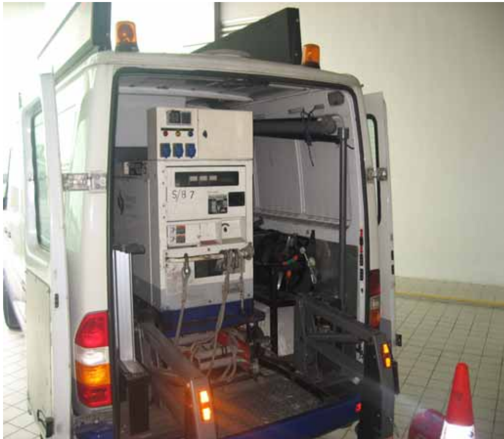
圖十七 搶修工作車配備的移動式發電機
