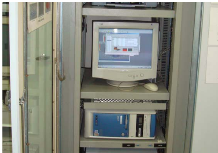
圖 4-3：400KV GIS 線上局部放電監測系統
