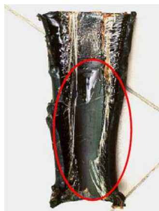
電纜終端void放電
