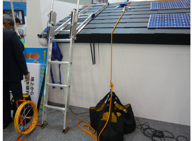
照片 20. 屋頂作業用工作梯
