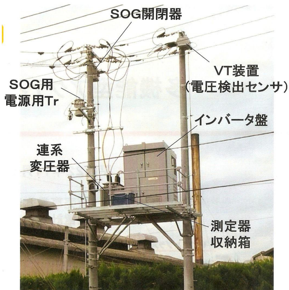
圖 4-7-3-2 中電試驗設置之多機能型主動式濾波器
