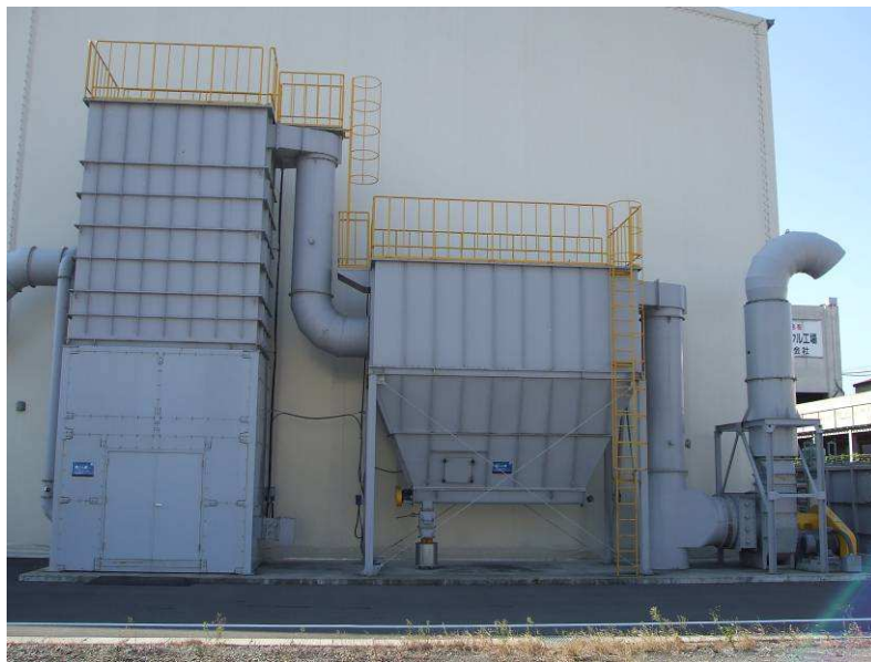
圖 2-9、後端空氣處理設備
