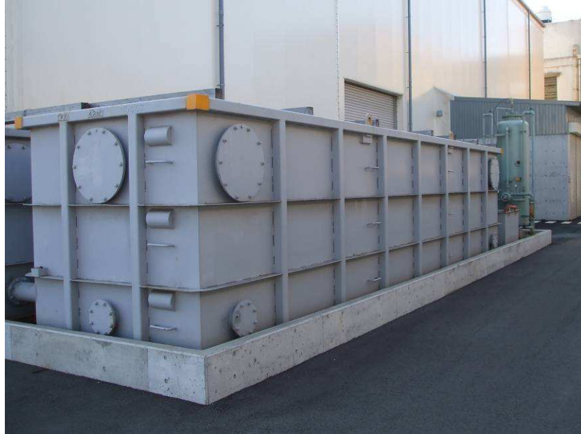
圖 2-8、緊急廢水處理設備
