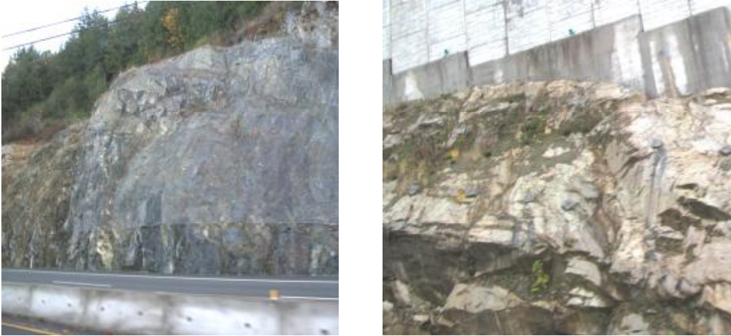
圖 40 卑詩省海天廊道道路邊坡所設置的防落石網(左)及岩釘(右)，攝於 2010 年 11 月 2 日。
