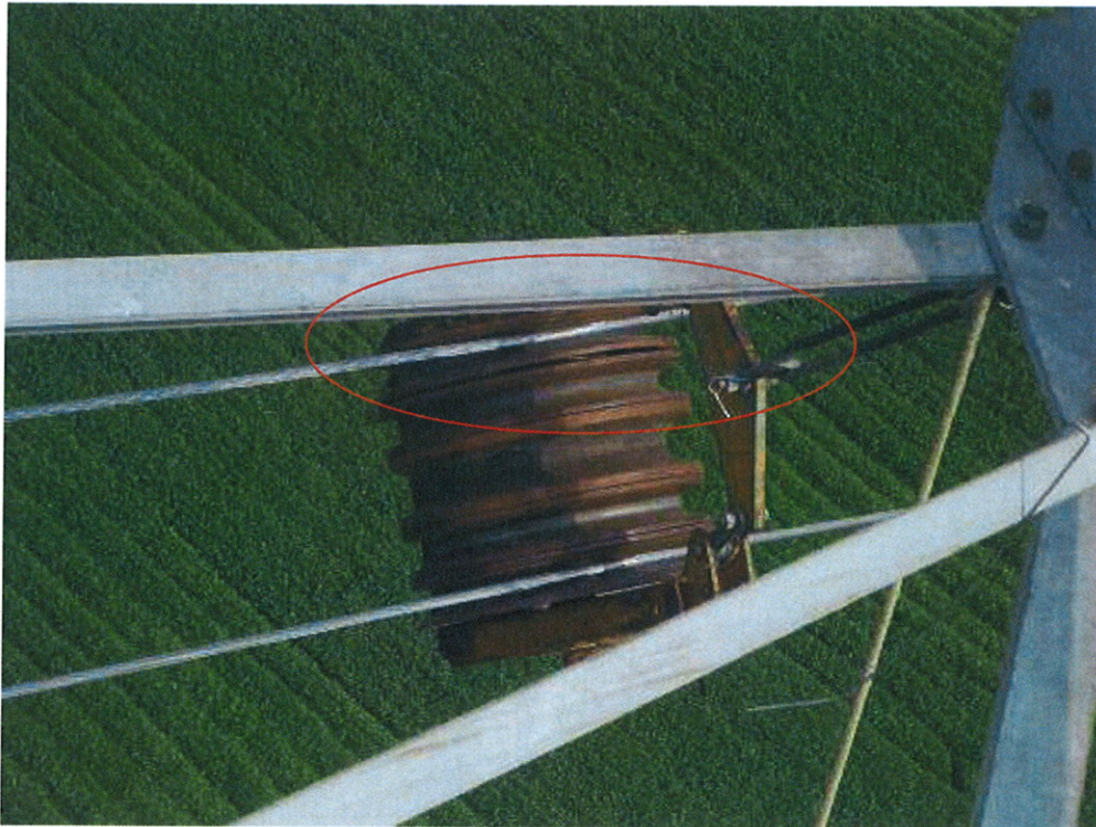
本公司台東~大武 161kV 線延線情形(導線延線角度已偏差)
