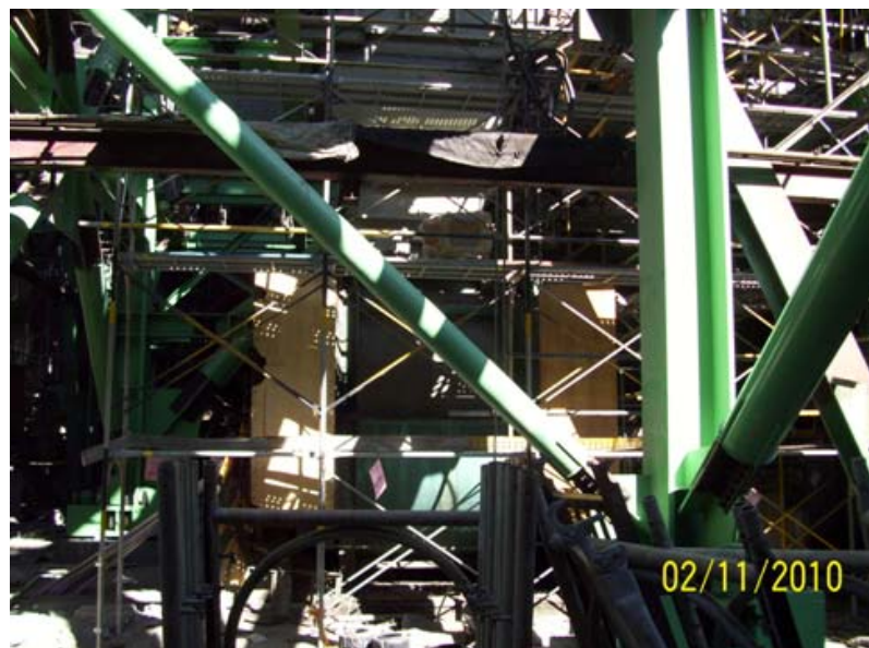
圖 3-3 二號機北側 PA fan 吸入口風箱與 SCR 鋼構斜撐干涉
