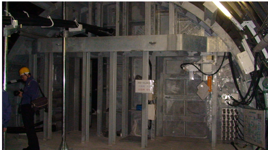
照片 3-2 防水門（電磁閘式）之範例----定川橫斷洞道內實例
