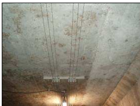
照片 3-7(1) 火災偵測線
