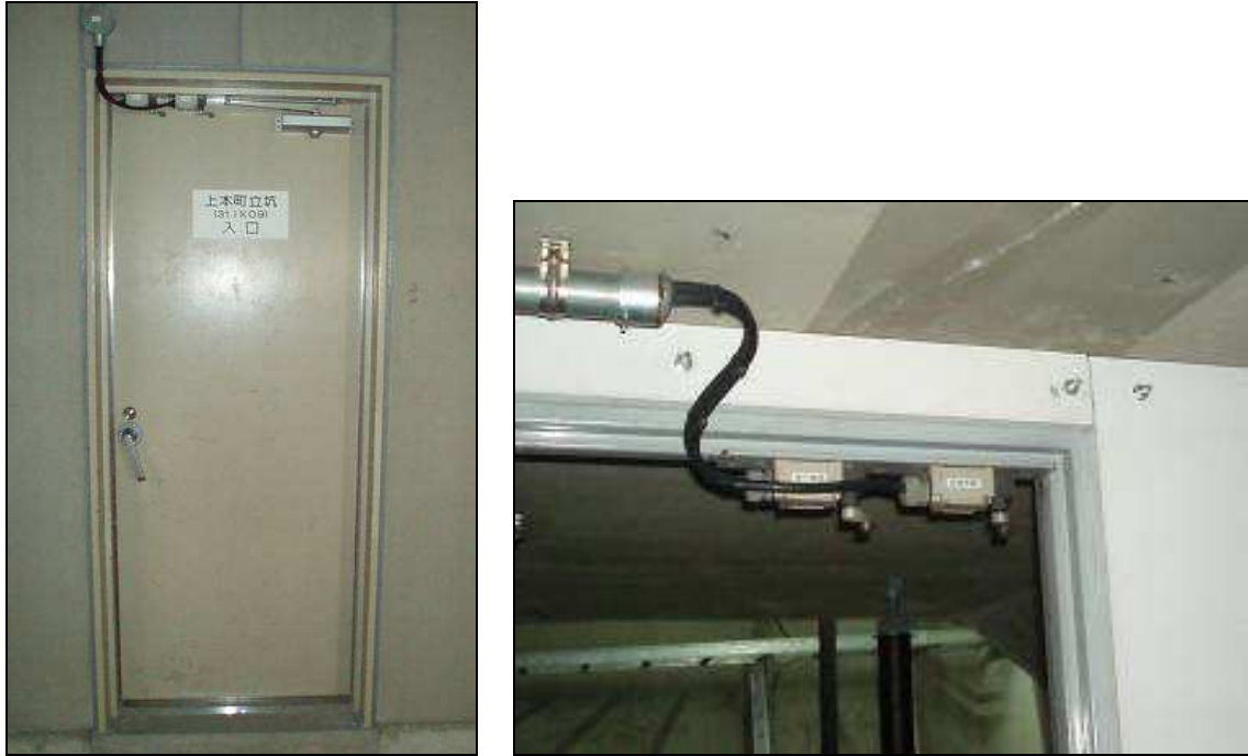
照片 3-5 洞道入口處之門扉開閉感應器
