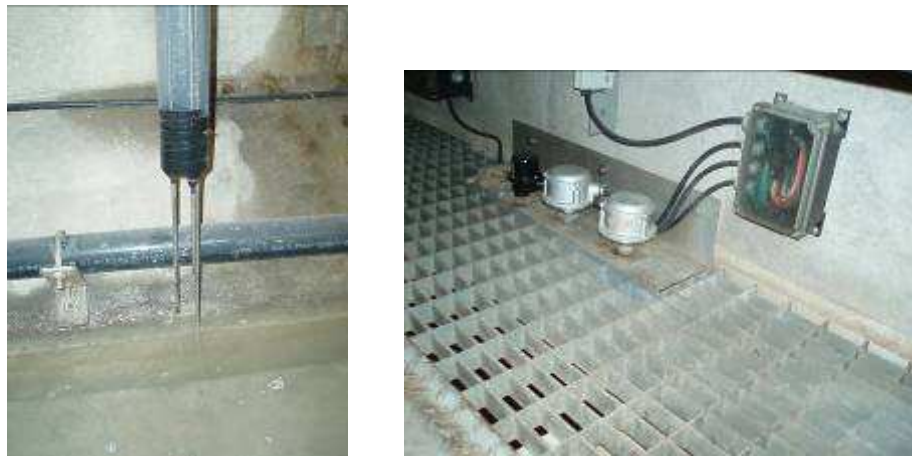
照片 3-1 水位控制用電極的實例
