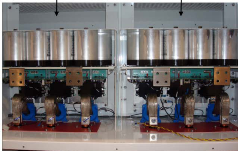
電力電子與電容器組合，GT500 系列 inverter 有兩組，各負責 250kW 切換
