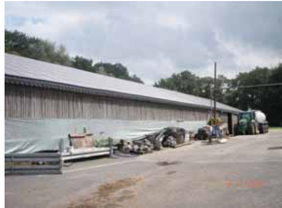
圖 14. 豬舍屋頂裝設太陽能板。
