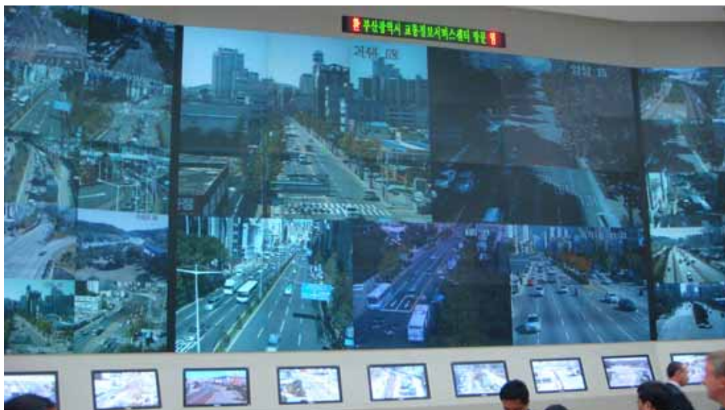
圖 20、交通資訊中心 CCTV 影像
