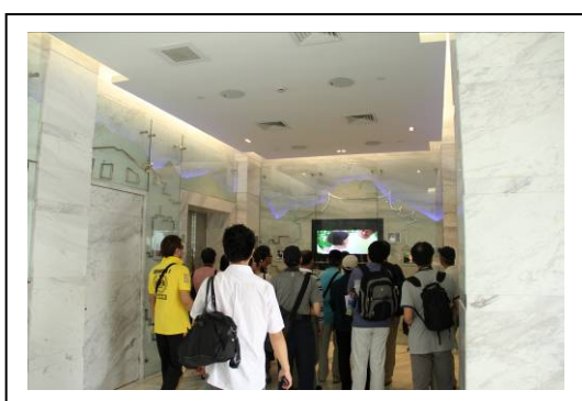
台灣館內天花板上方偵煙設備
