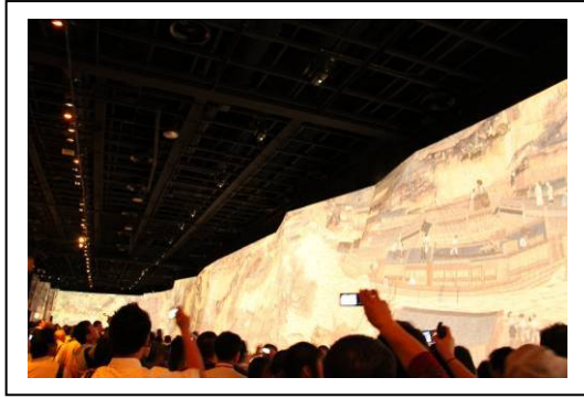
上河圖展覽場地（上方自動撒水頭設備）
