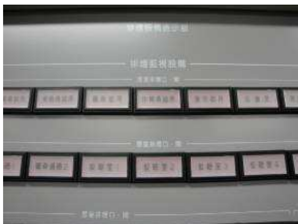
排煙監視設備
