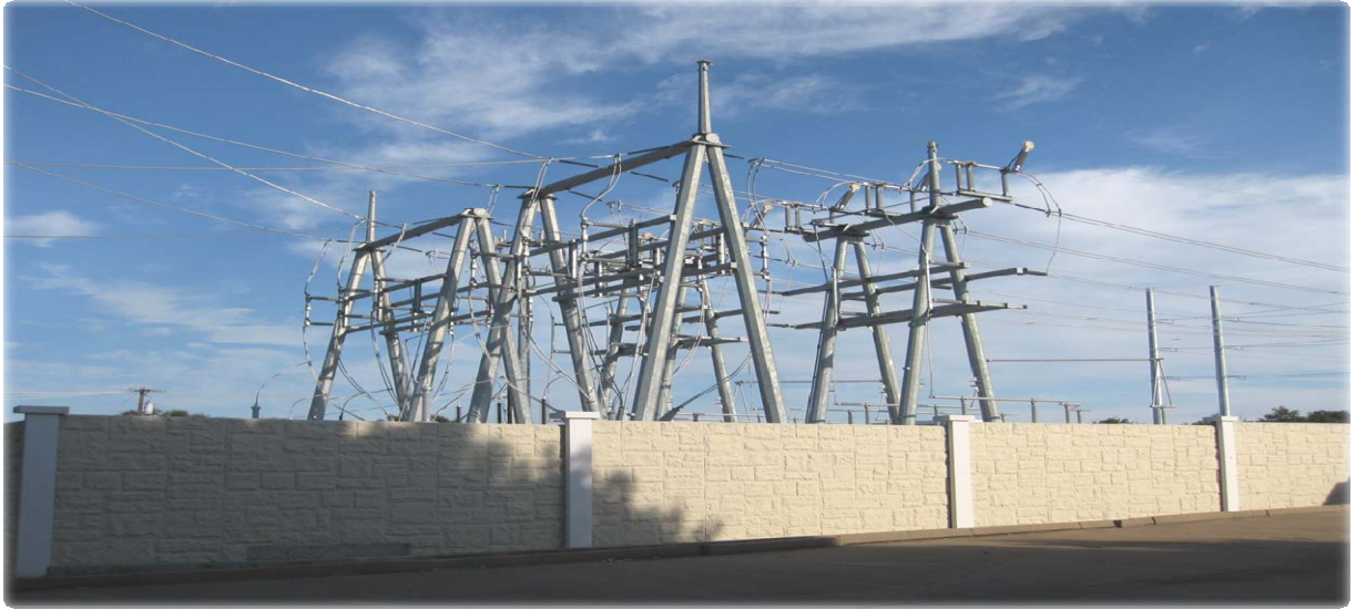
德州 無值班人員變電所
