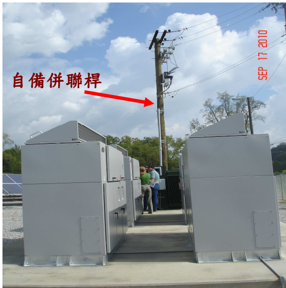
圖 2.7 1MWp 太陽光電廠(a)- Inverter 及自備併聯桿
