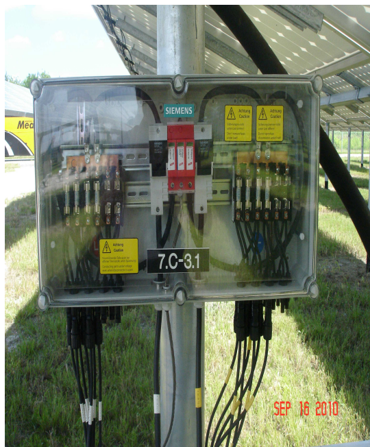
圖 2.5 10MWp 太陽光電廠(c)- 直流接線箱
