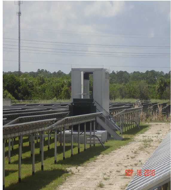
圖 2.4 10MWp 太陽光電廠(b)- 升壓變壓器及 Inverter
