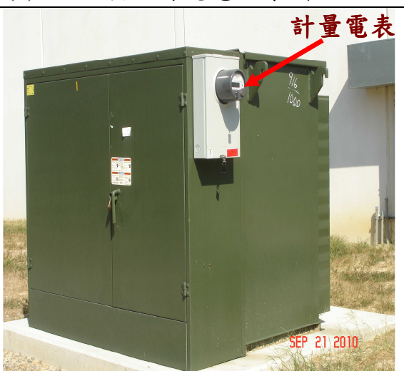
圖 2.16 高壓用戶屋頂 1MWp 太陽光電廠 (d) - 併聯升壓變壓器及計量電表
