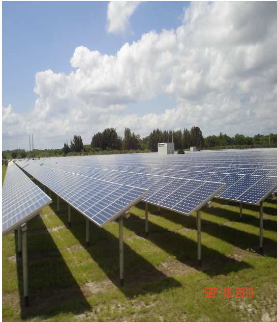
圖 2.3 10MWp 太陽光電廠(a)- 全景圖
