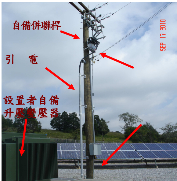
圖 2.9 1MWp 太陽光電廠(c)- 設置者自備升變壓器及併聯桿
