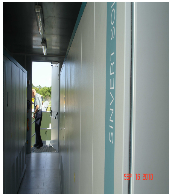
圖 2.6 10MWp 太陽光電廠(d)- 採用之西門子 Inverter
