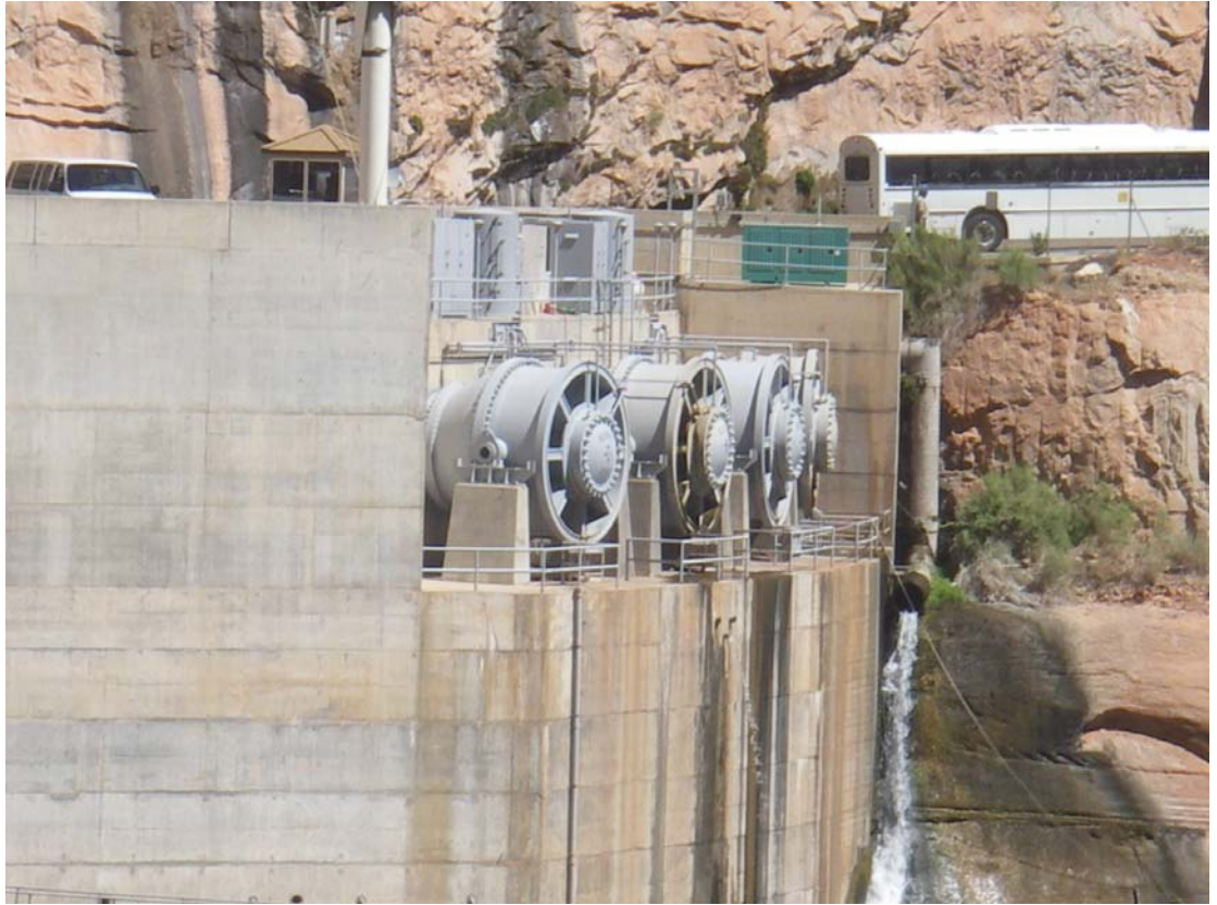
照片 18 格蘭峽谷(Glen Canyon)壩出水工中空噴射閥
