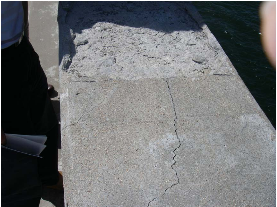
照片 1 壩頂胸牆混凝土龜裂及部分脫落
