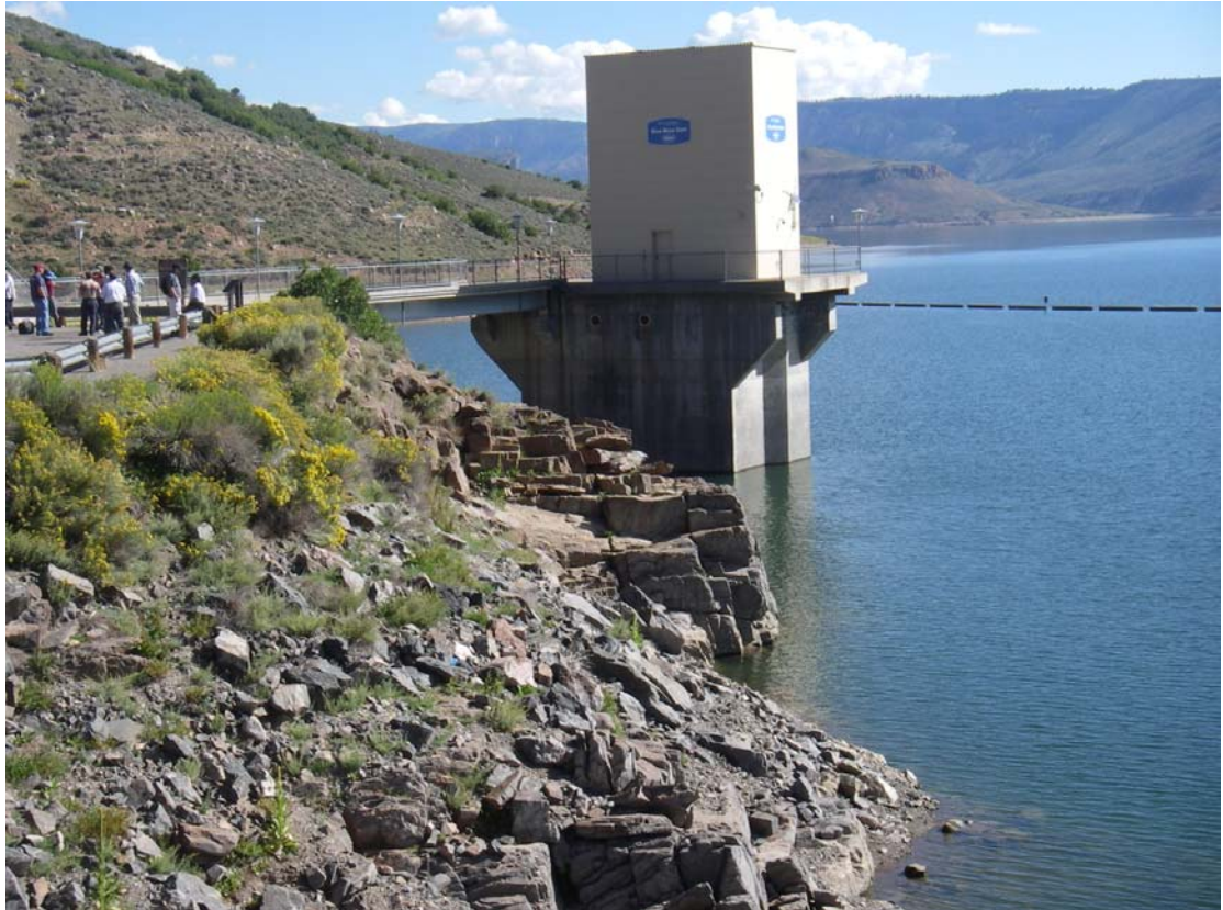
照片 5 布魯梅薩 (Blue Mesa) 壩出水工進水口結構物
