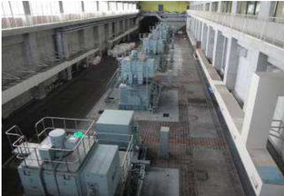
圖 3-43 毛馬抽水站機房，抽水站內共有 6 部抽水機，每部 55cms，共計 330cms 抽水容量
