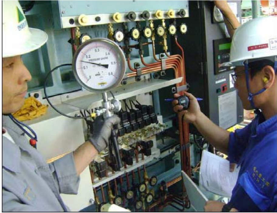
安全保護裝置測試 滑油進口低壓停機
