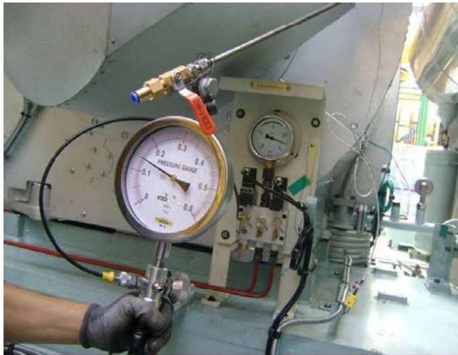
安全保護裝置測試 增壓機滑油進口低壓停機
