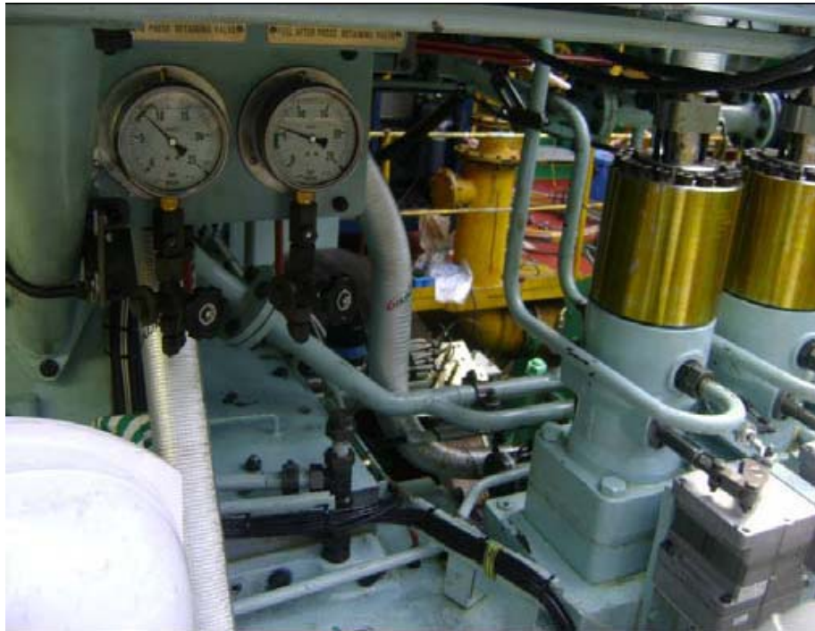
主機廠試 安全保護裝置測試
