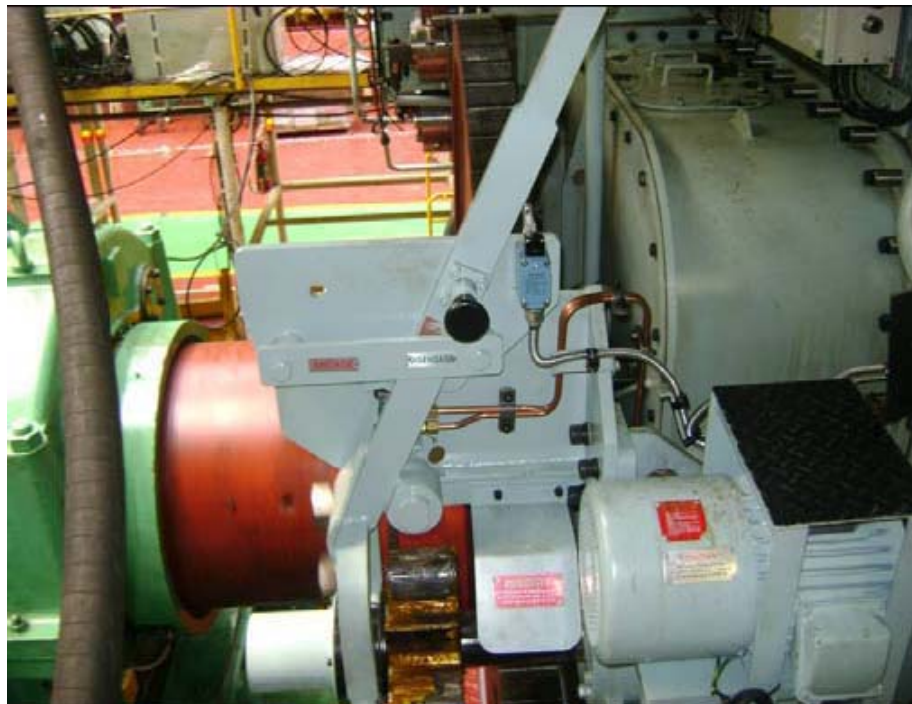
安全保護裝置測試 轉車機起動互鎖
