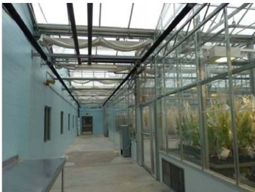
圖39. AAFC之基因轉殖植物中心隔離溫室冰熱水升降溫、供水、供電與消防等系統相關管路設於通路上方
