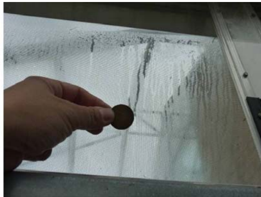
圖49. AAFC之基因轉殖植物中心隔離溫室溫室的側窗外部均包覆有防蟲網的設置，以防止昆蟲與雜物進入溫室。
