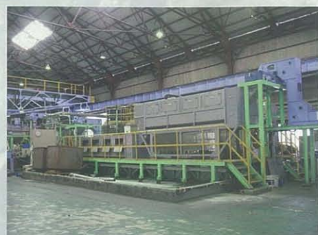
6 酸洗浄・乾燥装置 (トロンメル洗浄機)
