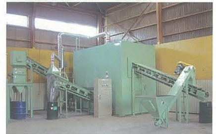
使用済み乾電池処理設備外観
