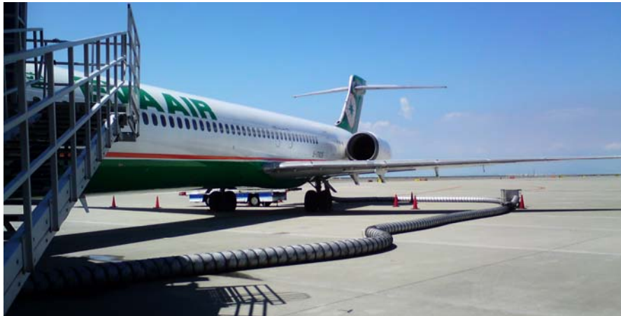
圖 四 經由機坪地下管路提供作業所需之氣、電源
