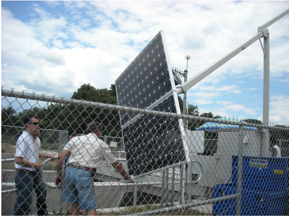
圖 4-11 聖約翰河流域防洪閘門自動控制站設施現場解說
