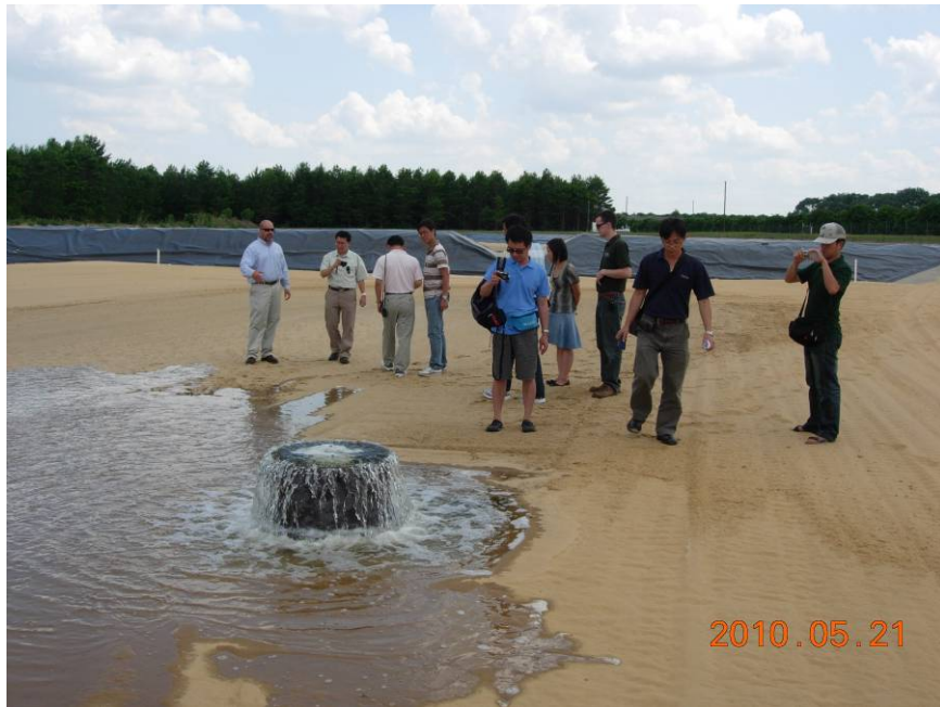
圖 4-24 Water Conserv II 人工快速地下水補注滲透盆地
