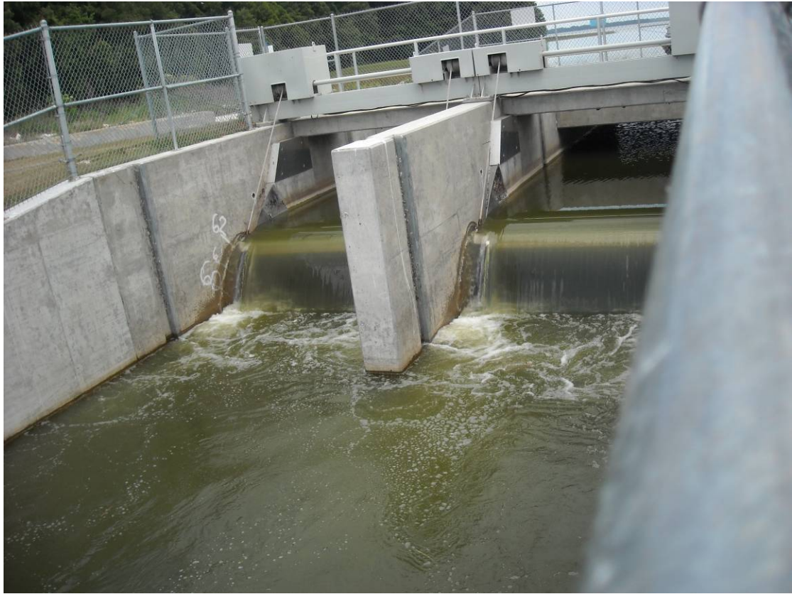
圖 4-13 聖約翰河流域防洪閘門自動控制站之水門
