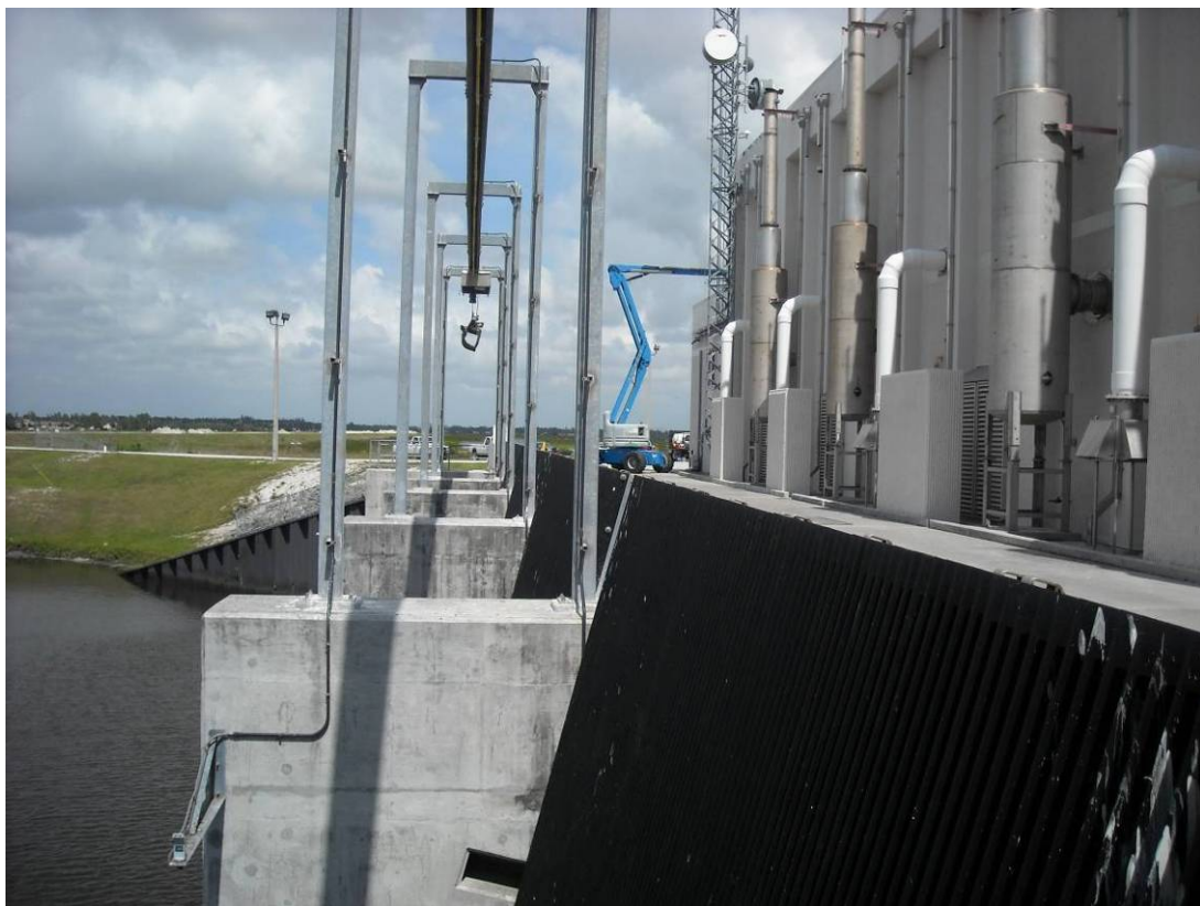
圖 4-6 污水引入人工溼地之抽水站進水口設施
