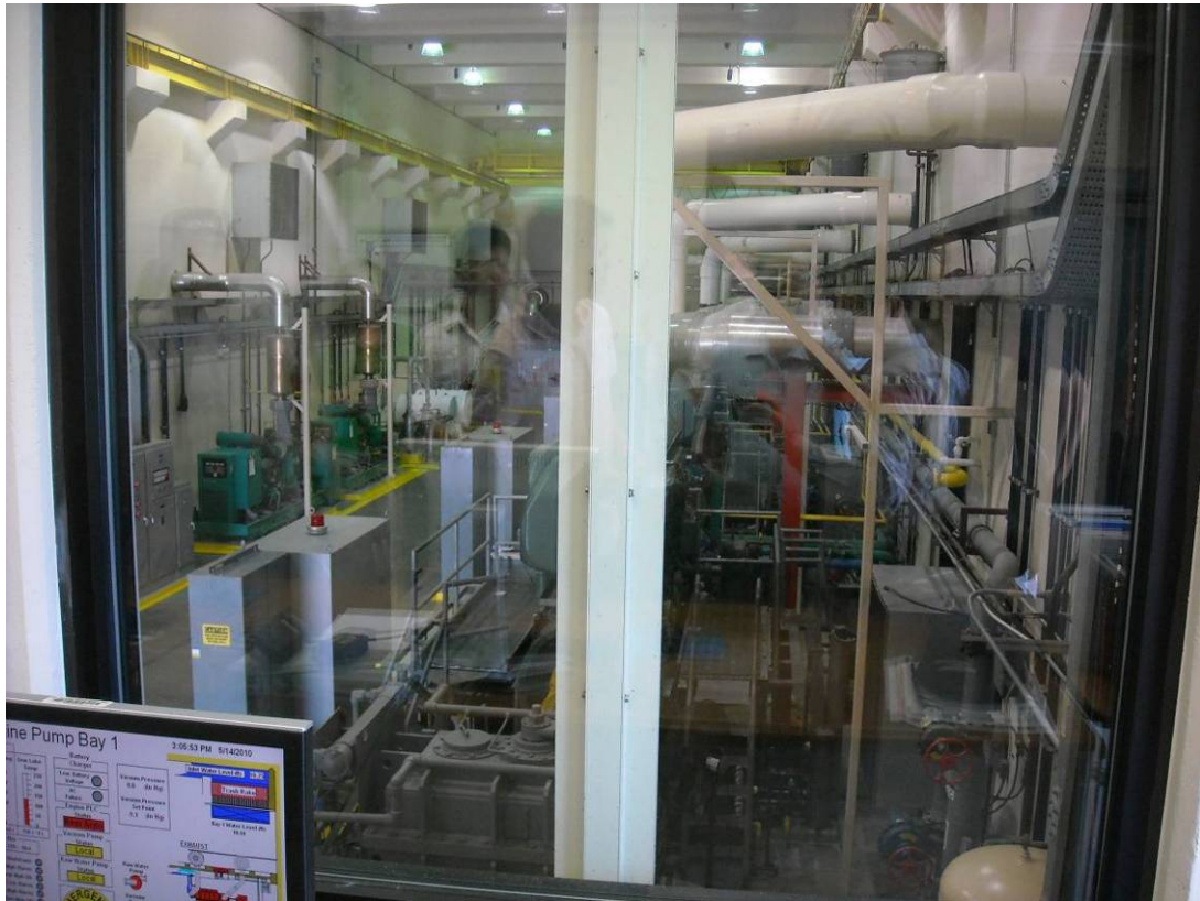
圖 4-5 污水引入人工溼地之抽水站室內設備
