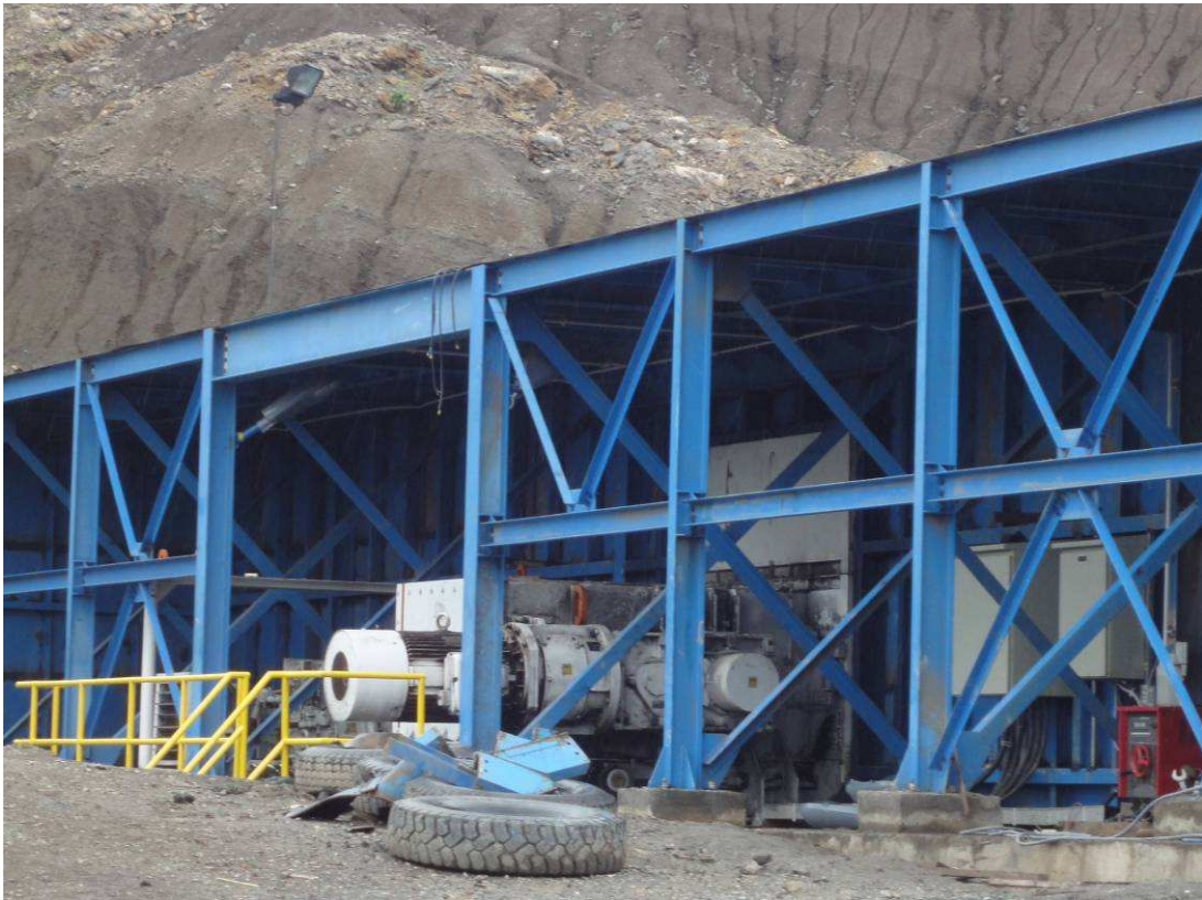
圖1-4 Megaprima Persada礦原煤進料斗與碎煤機
