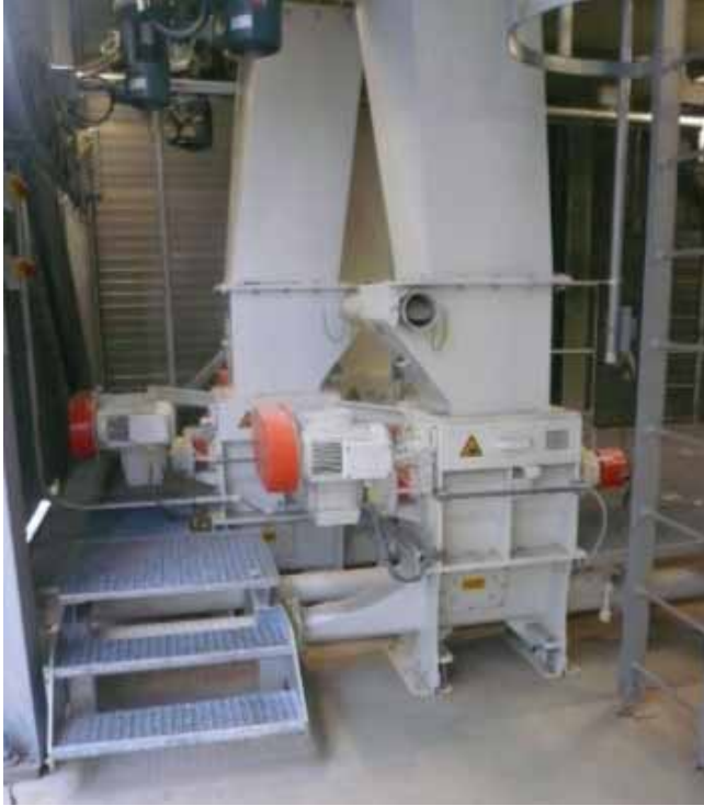
左圖顯示螺旋飼料機(Screw Feeder)設備將粉末生質燃料送入燃料主要輸送管，並接續由風扇供氣推送注入至燃燒器。
