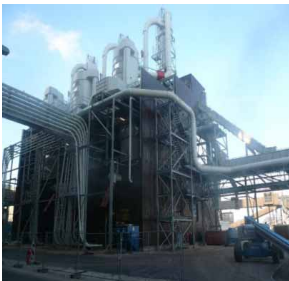
如圖示為受建築物包圍之磨粉機，其上方各有旋風器設備將生質燃料粉末由流動氣體內分離後收集，其次可看到各生質燃料輸送管從生質燃料倉底部外接出來。
