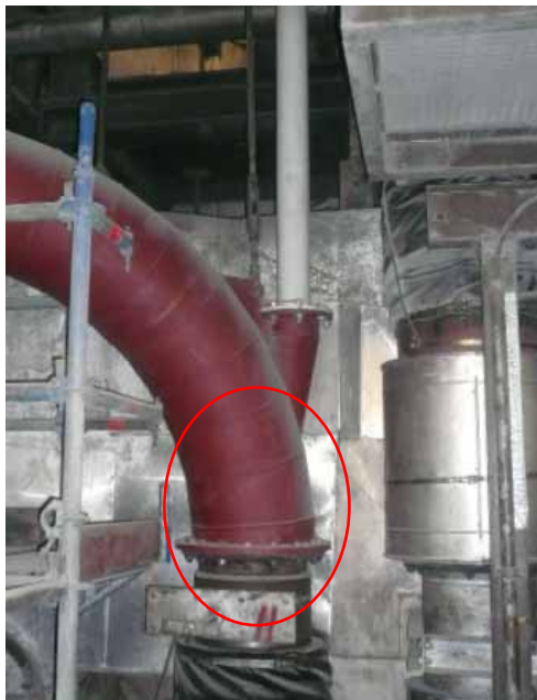
如圖示為燃煤分管注入生質燃料，鍋爐仍沿用舊的 Low Nox 燃燒器設備(The Dutch manufacturer STORK)，基本上燃燒器本身並未因為加用生質燃料而作修改，而是採取直接在燃燒器上游燃煤分管處注入生質燃料，如圖中彎管處即為生質燃料之注入點。
