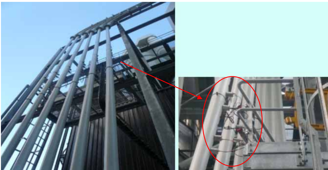
圖左為併列之生質燃料各輸送管段，於維護操作平台上方可隱約看到凸出的一些感測器，作為生質燃料流量控制用(PROMECON MECONTROL coal 24 x for biomass firing control)，近看如箭頭處右圖所示，各生質燃料垂直輸送管段皆個別裝設有 4 支(兩組)微波流量感測器。
