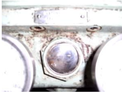
推力軸承回油視窗(inactive)
