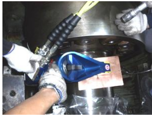
高壓 TE 端加配重位置
