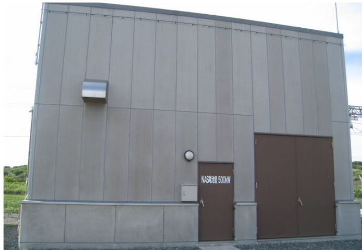
圖四十二：500kW NAS 電池模組
