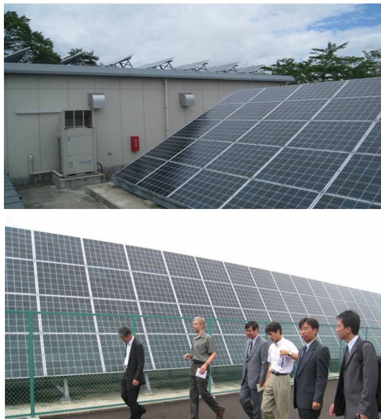
圖五十七：仙台微型電網 50kW PV 模組
