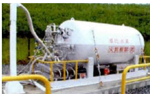
圖 27 液化氫氣儲存槽
