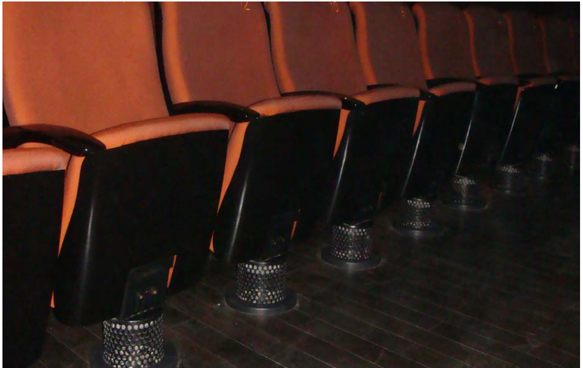
廣州大劇院—座椅區下方空調出風口
