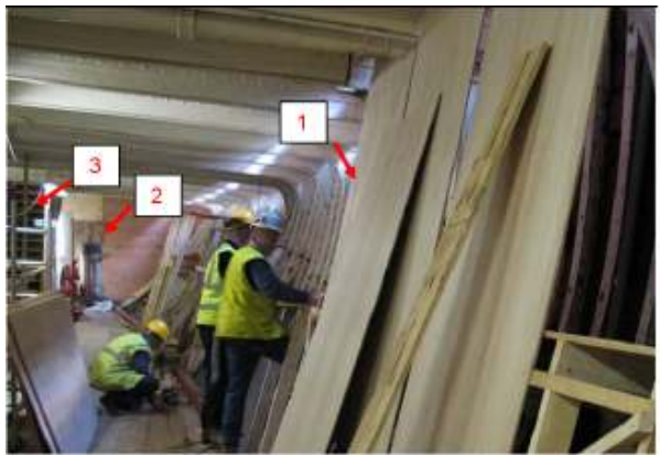
照片 32：火災前下層船尾端附近之位置圖，標示 1 為三夾板，標示 2 為工業真空吸塵器及標示 3 為船尾端之樓梯。
