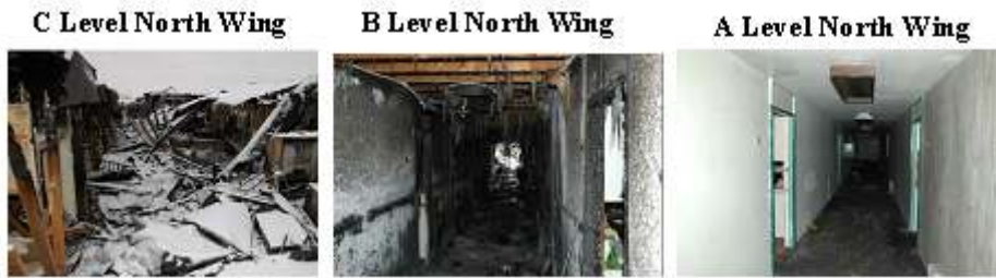
照片 42~44：公寓北翼之樓層 C、B 及 A 之燃燒狀態。
