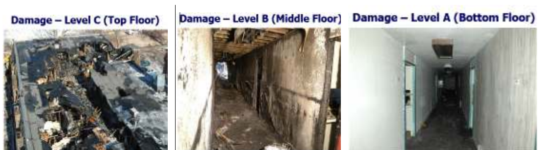
照片 39~41：樓層 C、B 及 A 之倒塌及燃燒現象。
