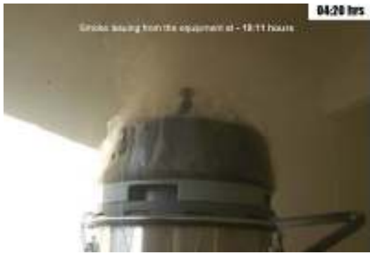
照片 33：經過 4 小時 20 分鐘後聽到雜音，現場已開始冒煙。
