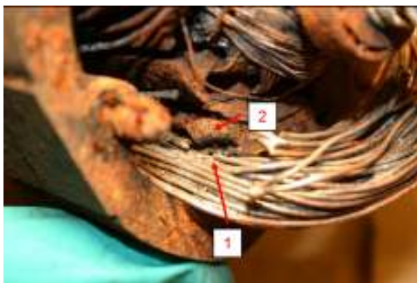
照片 33：馬達線圈上相鄰之層間電線局部有非常嚴重之熔化情形。
