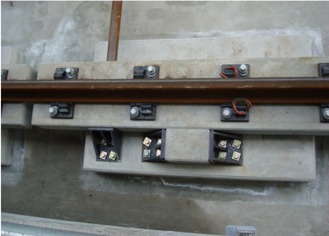
照片 2.2.4.2-2 梯形軌枕固定鐵件及鋼軌扣件
