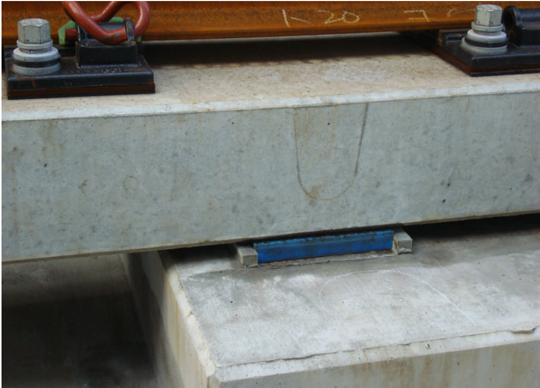
照片 2.2.4.2-4 梯形軌枕與支承墊間之彈性墊片
