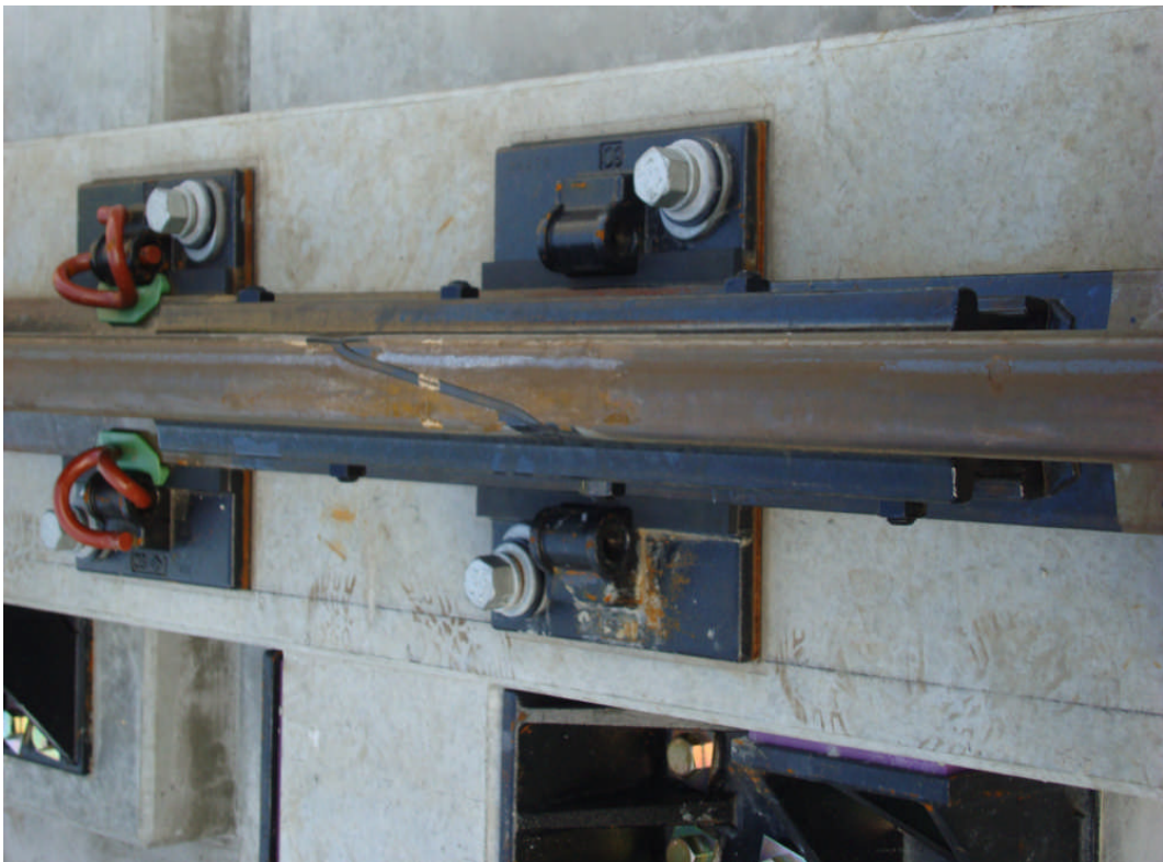
照片 2.2.4.2-3 鋼軌連結鐵件
