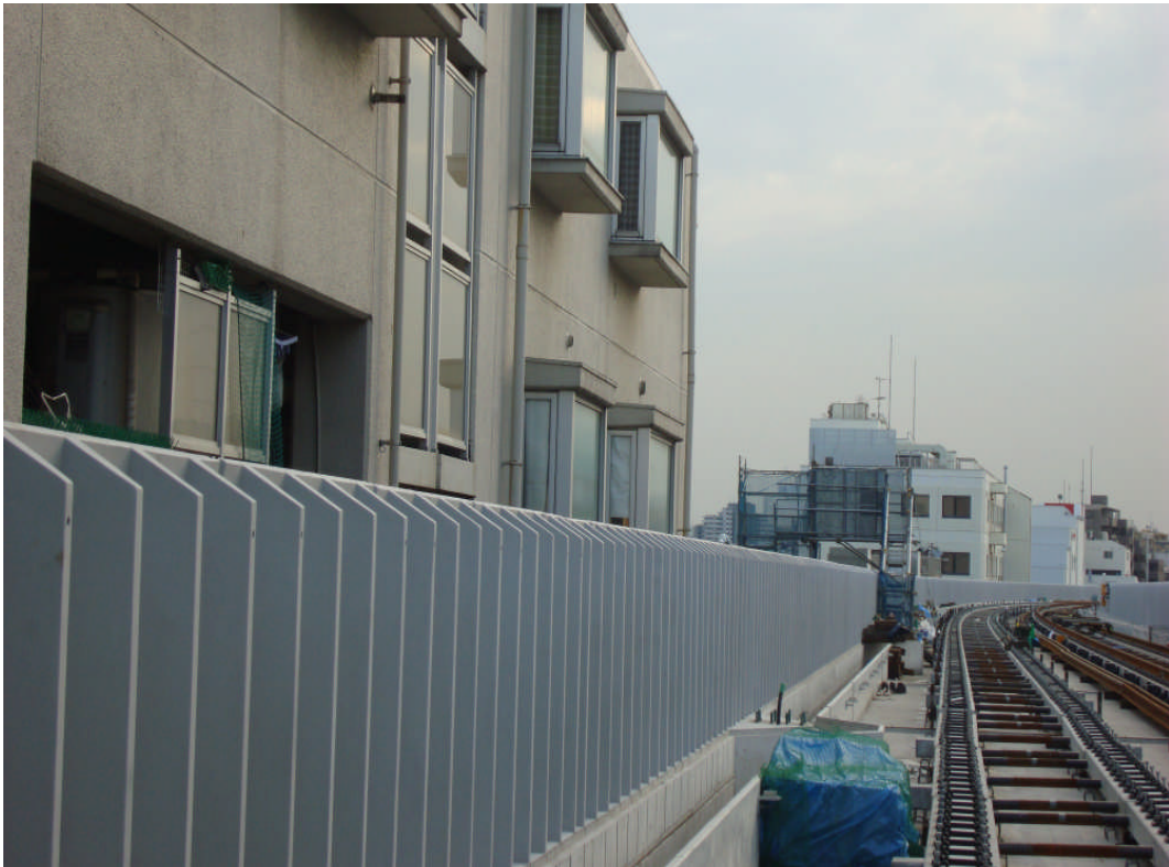
照片 2.2.4.2-5 隔音牆緊鄰民房
