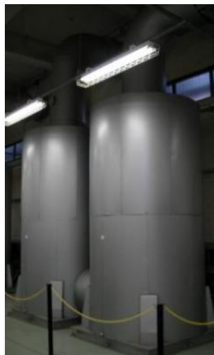
圖 27、發電機廢氣處理裝置
