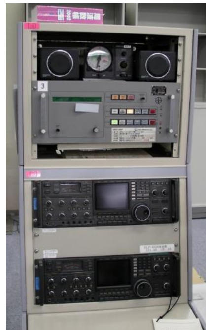
圖 18、通訊錄音設備
