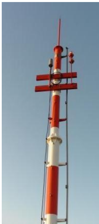
圖 61、場面系統 SSR 訊號接收器天線
