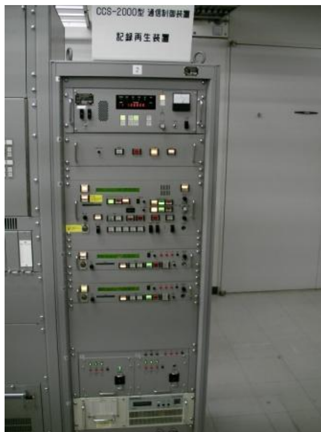
圖 81、CCS 錄音設備
