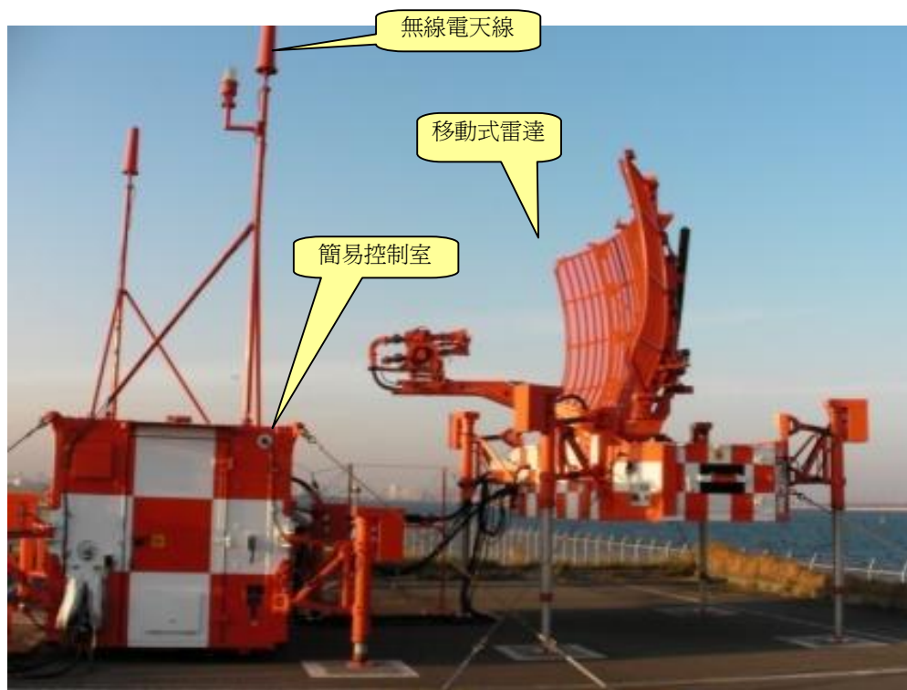
圖 69、移動式雷達及簡易管制室
