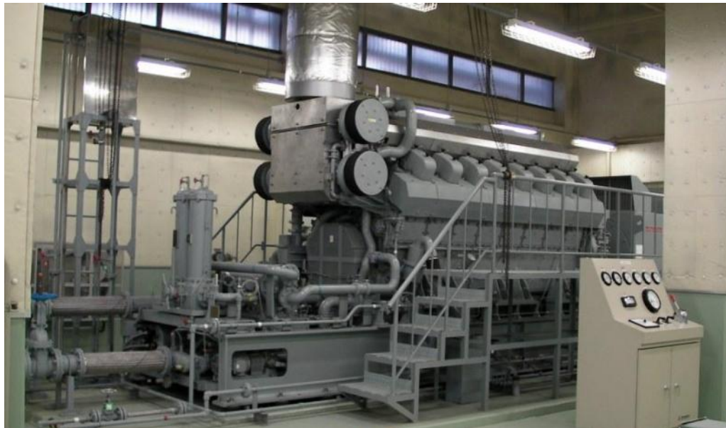
圖 26、3000KVA 緊急發電機
