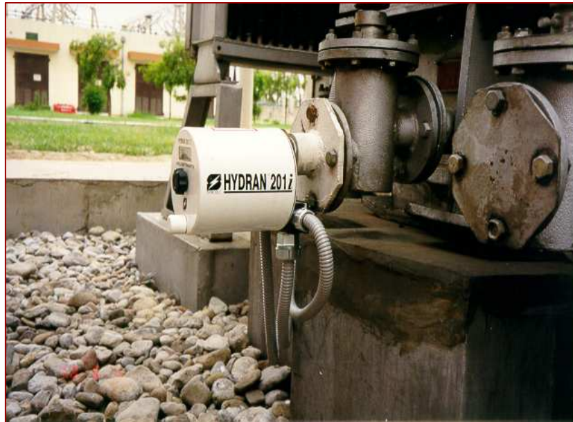
圖 4.18 Hydran 201i 油中氣體分析設備應與地面保持水平
