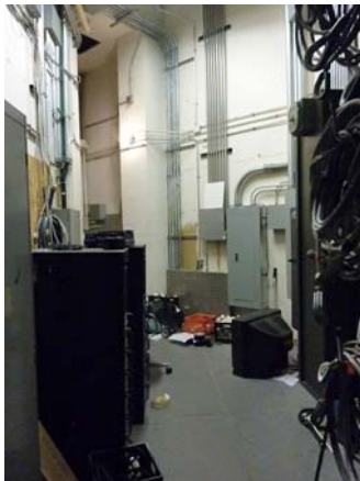
活動配電設施區
