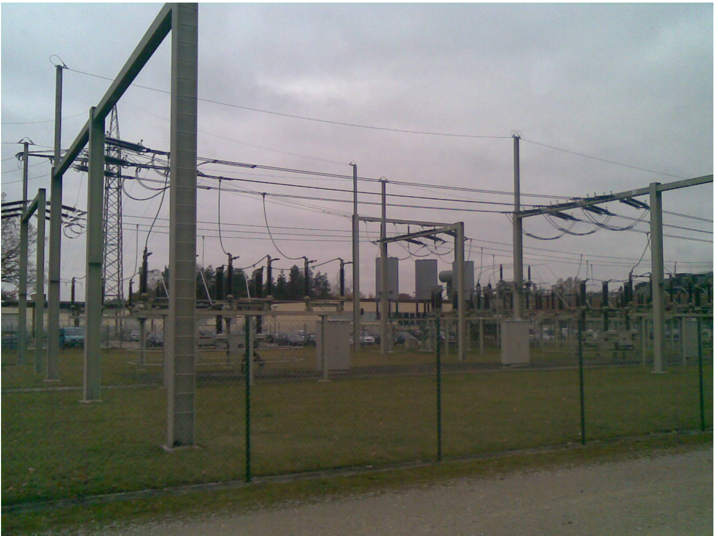
圖二十. N-ERGIE 電力公司變電所
