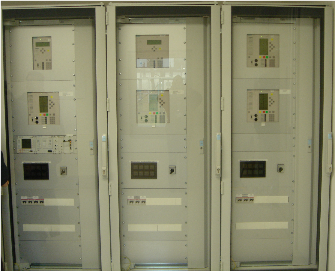
圖二十一.控制室保護電驛
