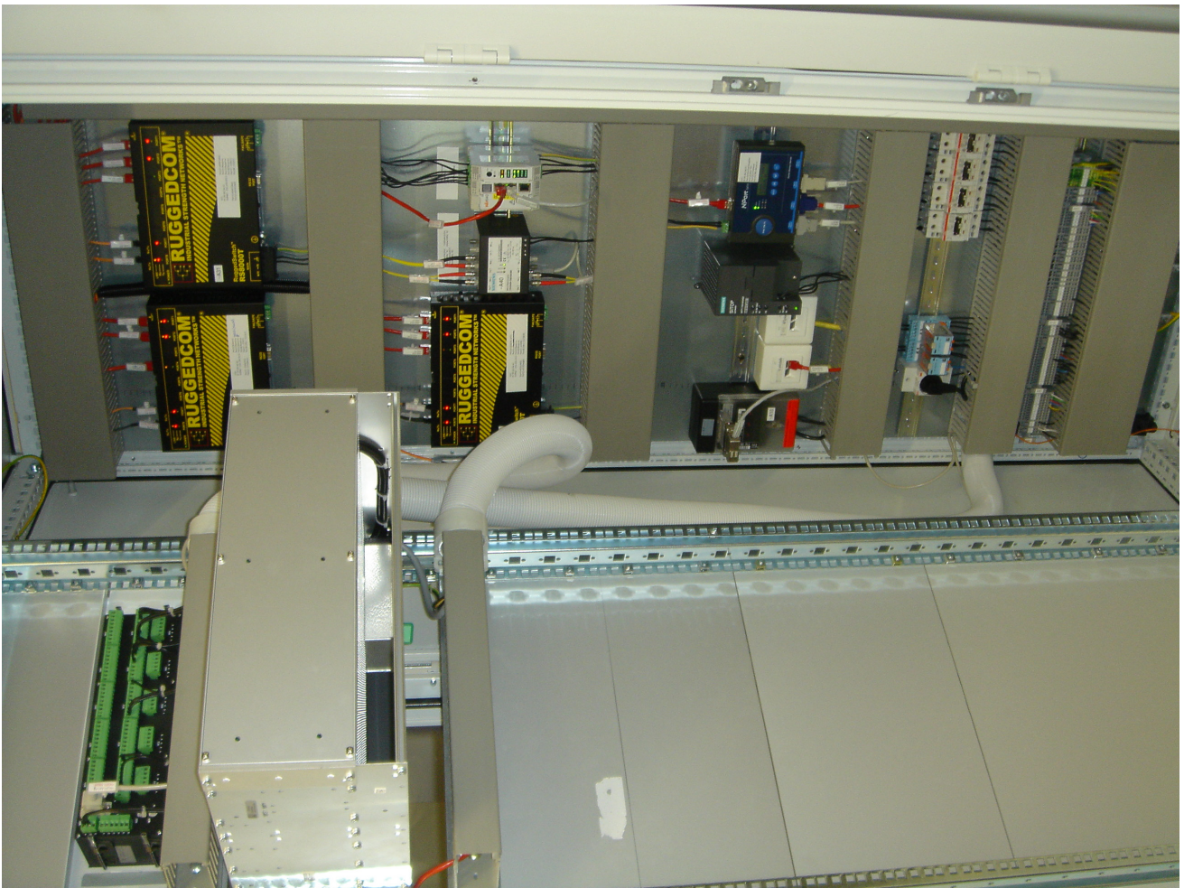
圖二十二.變電所之通訊模組
