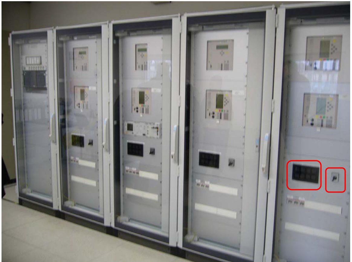
圖 22：120kV IED 保護及自動化機櫃
