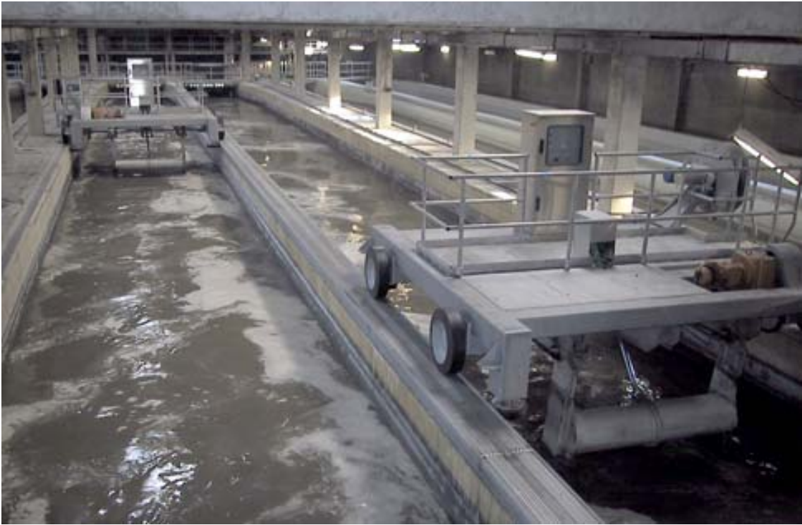
自動刮除式沉砂池（6）
