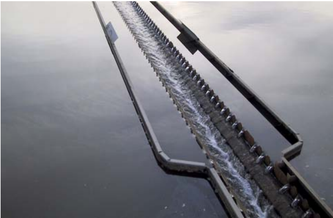
沉澱池集水渠(含浮渣防止裝置)(9)
