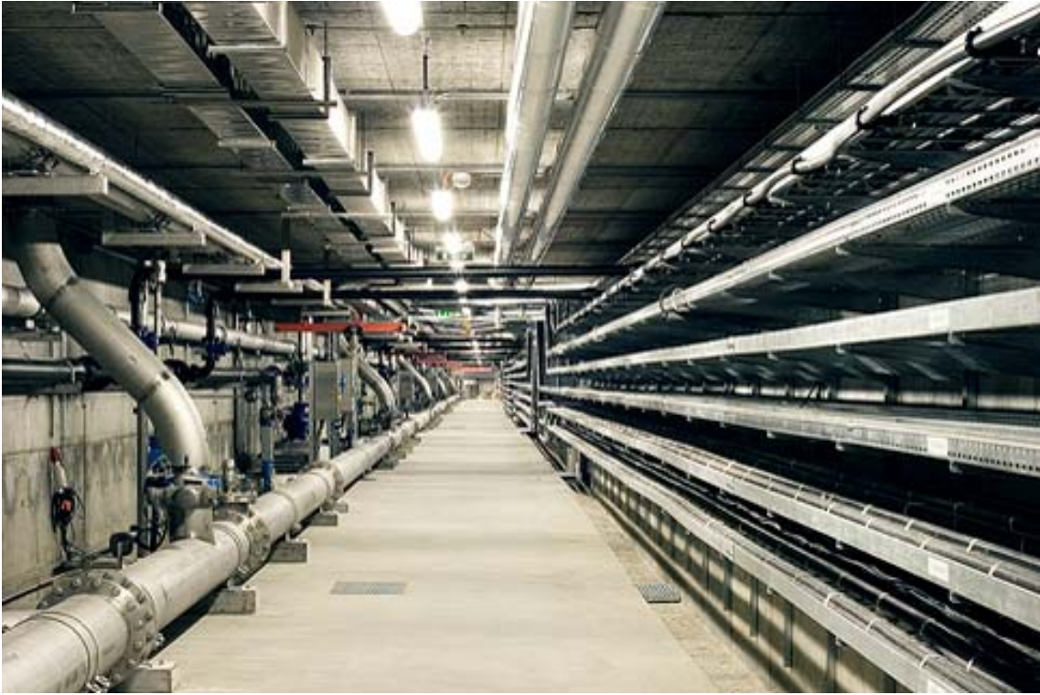
佈線、佈管完善的管道間(20)
