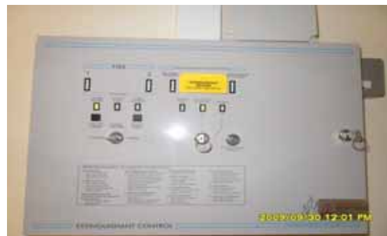
ORO 庫房消防設備監控系統
