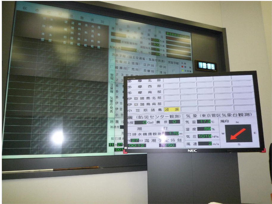
東京都防救災中心視訊設備-4
