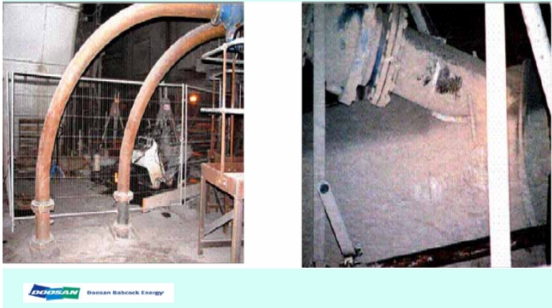
圖九、英國Drax電廠直接混燒生質燃料管路及噴入點
